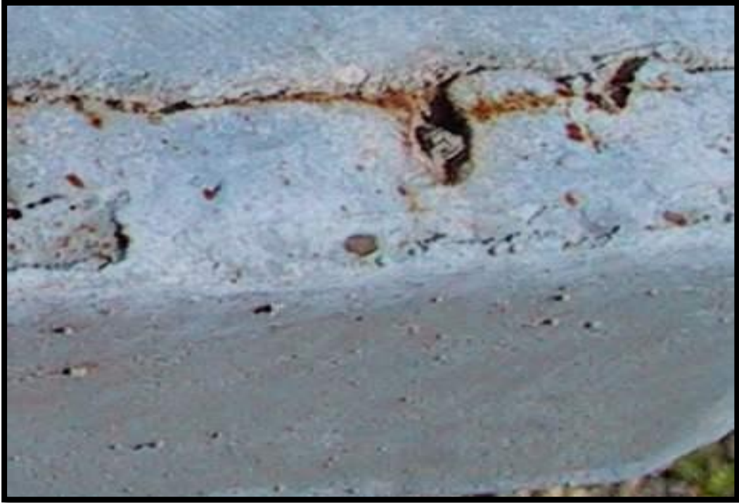
Figure I.9 : Corrosion caverneuse du fer dans l'air
