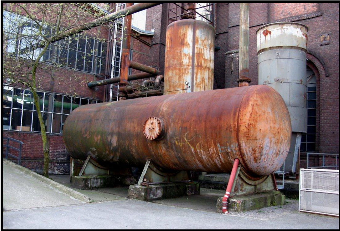
Figure I.2: Corrosion uniforme d'une citerne à eau.
