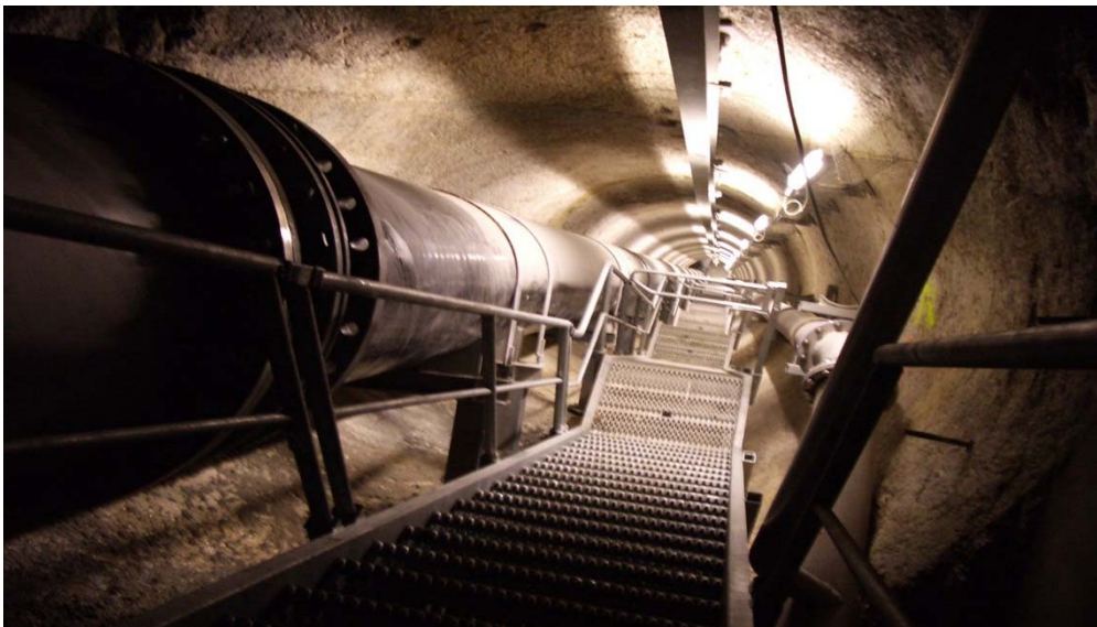
Figure 18 souterraine - conduite de refoulement
