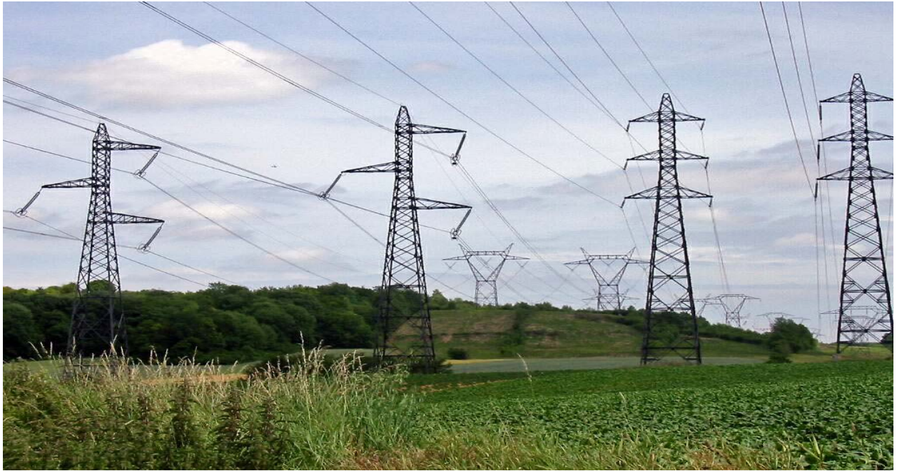
Figure 14 Type poteau de haute tension (HT) concerne les tensions (250 KV à 63KV)
