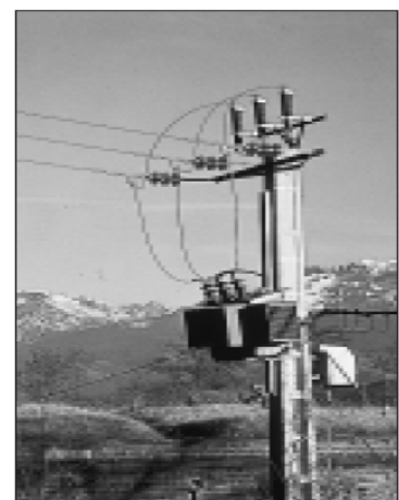
Transformateur aérien (Schneider Electric).
