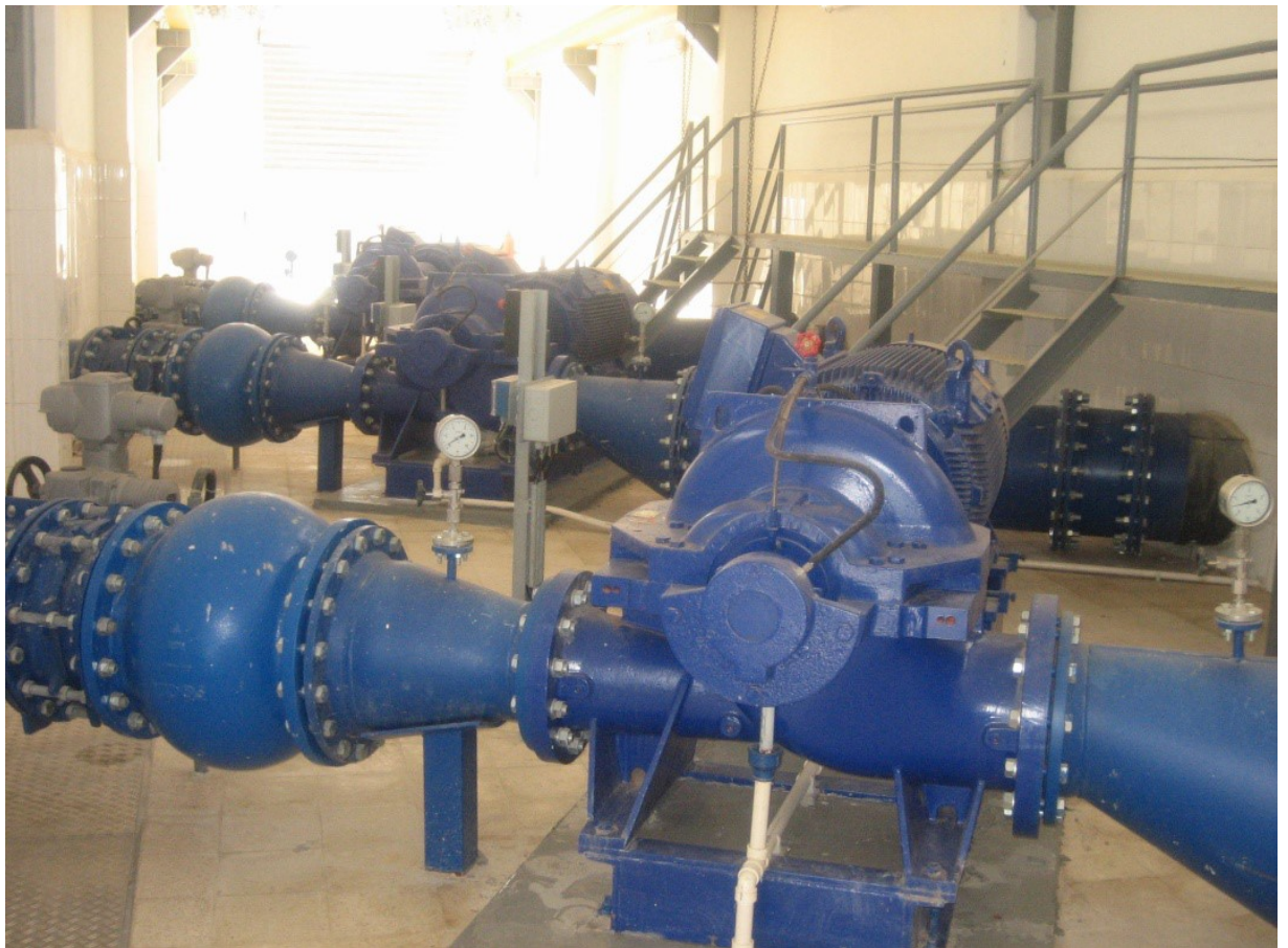
Figure 3-4 : Vue de générale des groupes électropompes
