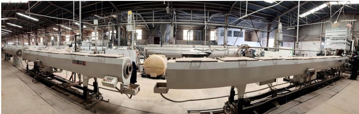
Fig1.1: Installation d'une ligne d'extrusion de tubes HDPE.
